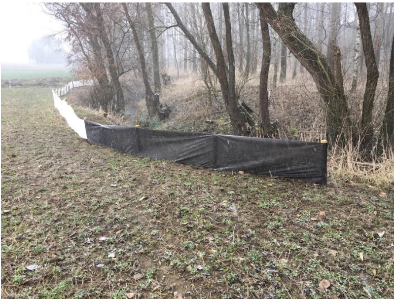
Abb. 28 Sedimentauffangzaun entlang des Pleißingbaches im Winter 2018/19. Foto: G. Lützenburg, 2018.
